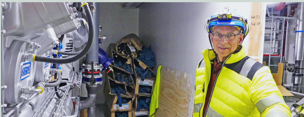
Viggo Søderblom ved siden av det pumpende «hjerne» i det nye sykehuset og helsehuset. Varmepumpa henter opp bergvarme, fra 300 meter ned i fjellet under sykehuset.
