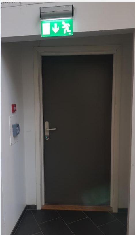
Figur 32 A, markeringslys mot nødutgang
