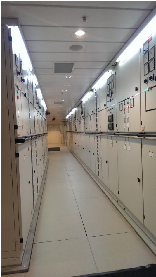
Figur 83, elektrisk hovedtavlerom med god belysning langs tavlerekke
